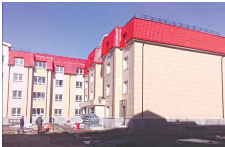
Детский сад на 40 мест по адресу: ул. Горького, д. 79. Площадь: 477,7 кв. м. Планируемый ввод в эксплуатацию: конец 3-го квартала 2015 г.
